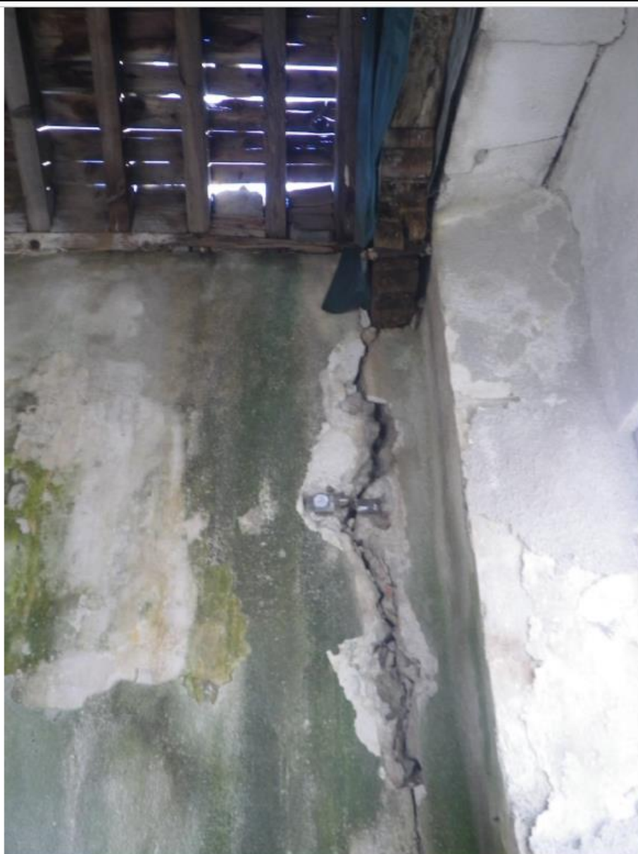
DISTACCO FACCIATA DAL CORPO DELLA NAVATA E STATO DEL TETTO
