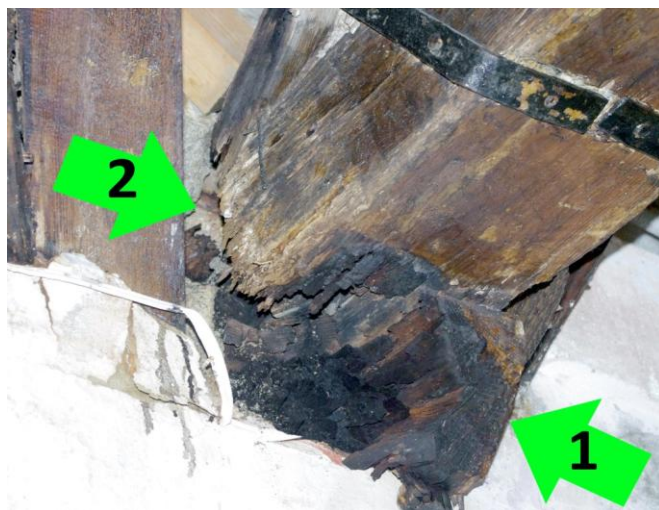
Disastroso stato di una capriata del salone
